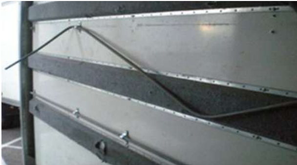
Estofos e hastes: hastes, fixações, estofos em falta ou deformados excedem a reparação económica
